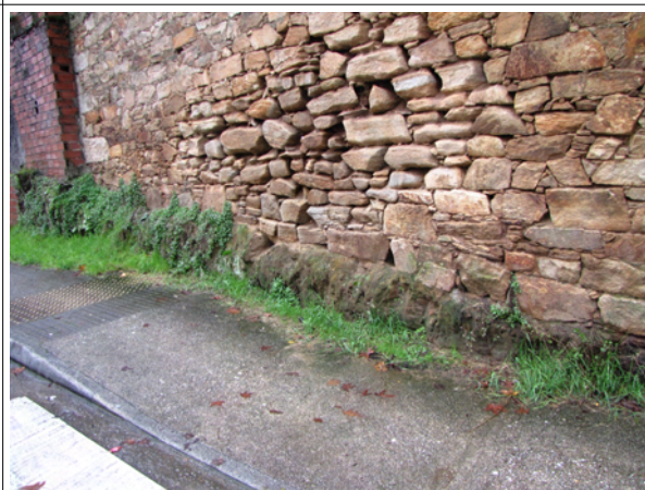
Afloramiento del substrato rocoso alterado bajo cimentación de muro en rua San Xoan
