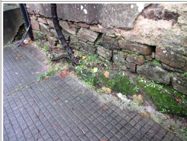
Afloramiento del substrato rocoso alterado bajo cimentación de muro en rua Vista Alegre
